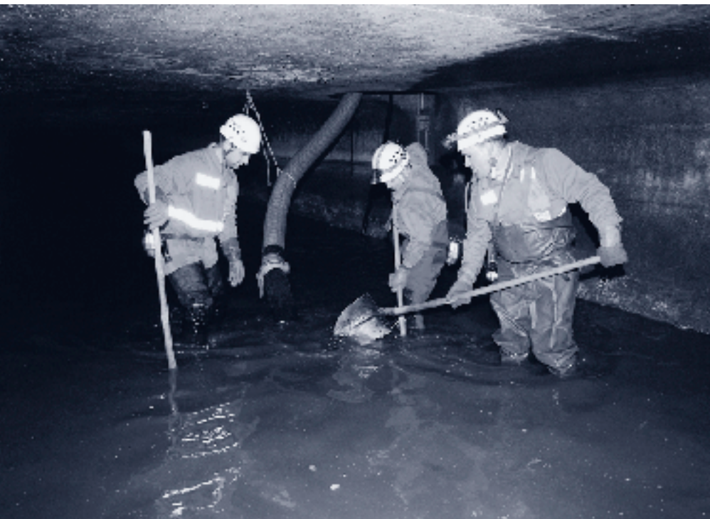
Travaux d'entretien dans les égouts effectués par des employés de «Entsorgung + Recycling Zürich».
